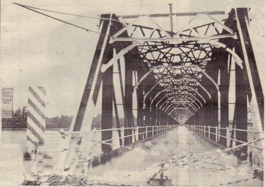
மட்டக்களப்பு, ஏப். 4 மட்டக்களப்பு, கல்லடி பழைய பாலம் புளரமைப்புப் பணிகளுக்காக தற்போது தற்காலிகமாக மூடப்பட்டுள்ளது. இந்தப் பாலத்தின் புளரமைப்பு பணிகள் முடிவடைந்தவுடன் மோட்டார் சைக்கிள் மற்றும் ஓட்டோக்கள் செல்வதற்கு அனுமதி வழங்கப்படும் என்று விதி அறிவிருத்தி அதிகார சபையின் கிழக்கு மாகாணப் பணிப்பாளர் வை. தர்மரட்ணா தெரிவித்தார். மட்டக்களப்பு, கல்லடி பழைய பால நிர்வான வேலைகளுக்காக மூடப்பட்டிருந்த லேடி மெனின் வீதியின் அபிவிருத்தி வேலைகளுள் தற்போது ஆரம்பிக்கப்பட்டுள்ளன என்று அவர் குறிப்பிட்டார். (ச)
