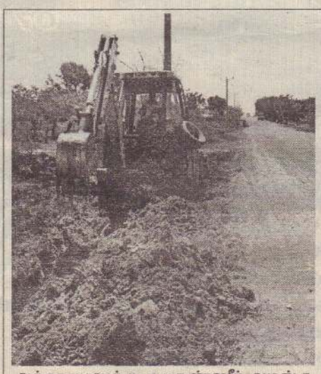
அக்கராயனுக்கு குடிதண்ணீர் வழங்குவதற்கு குழாய்கள் பொருத்தும் பணிக்காக குழாய்கள் அமைக்கும் பணிகள் குடிதண்ணீர் துறைமுகம் மூலமாக நடைபெற்று வருகிறது. (ஒ-18)
