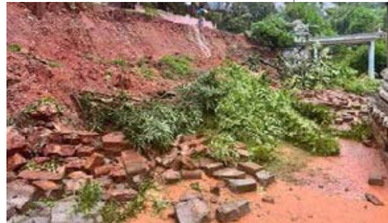
(கஸ்பர்) நாட்டில் நிலவும் சீரற்ற காலநிலையின் காரணமாக திருகோணமலையின் இலங்கநகர் பாலமுருகன் ஆலயப் பின்புற மதில் இன்று இடிந்து வீழ்ந்துள்ளது. பாலமுருகன் ஆலயத்துக்கும் இதனால் சேதம் ஏற்பட்டுள்ளதாக நிருவாக சபை தெரிவித்துள்ளது. தொடர் அடை மழை காரணமாக குறித்த அனர்த்தம் ஏற்பட்டுள்ளது.
