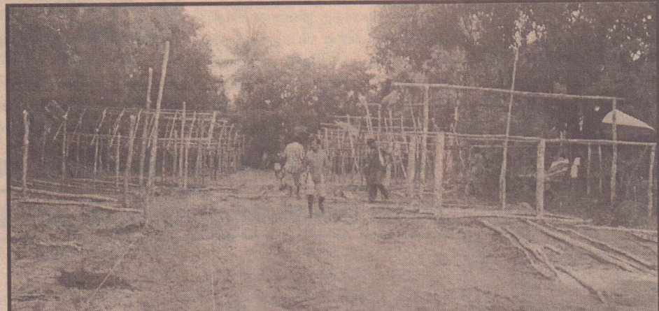
திருக்கோவில் பிரதேசத்தில் சுனாமித் தாக்கத்தினால் முழுமையாக அழிந்த தம்பட்டைக் கிராமத்தில் உள்ள 215 குடும்பங்களைத் தற்காலிகமாக அதே கிராமத்தின் ஒரு பகுதியில் மீள் குடியேற்றம் செய்வதற்கான தற்காலிகக் கொட்டில்கள் அமைத்துக் கொடுக்கும் பணியில் தமிழர் புனர்வாழ்வுக் கழகம் ஈடுபடுவதைப் படத்தில் காண்க. (படப்பிடிப்பு:- வி.பி. சிவப்பிரகாசம்)
