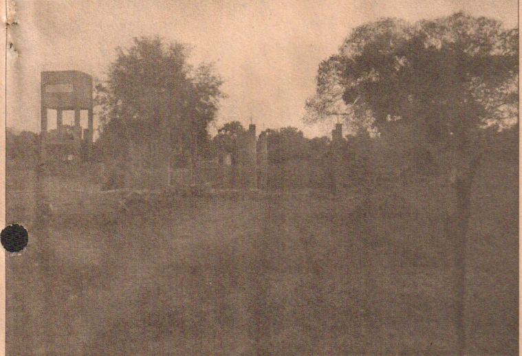
கொக்கிளாய் ஆரம்ப வைத்தியசாலைக்கான நிரந்தரக் கட்டடம் அமைக்கும் பணிகள் ஆரம்பிக்கப்பட்ட நிலையில் அதற்கான வேலைகள் நடைபெறுவதை படத்தில் காணலாம் (17)
