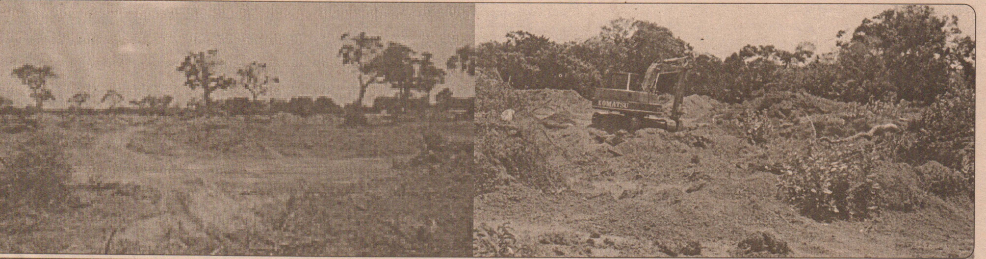
திருமுறுகண்டியிலிருந்து அக்கராயன் செல்லும் பிரதான வீதிக்கு அருகில் கிறவல் மண் ஏற்படும் பகுதியே கிதுவாகும். சுற்றுச்சூழல் தொடர்பான எவ்வித அக்கறையும் இல்லாத காட்டுப் பகுதிகளிலுள்ள மரங்களும் அடியோடு பெயர்த்தெடுக்கப்பட்டு கிறவல் மண் கிப்பகுதியிலிருந்து ஏற்படுகிறது. இந்த மண் ஏற்றும் பகுதிக்கு பின்பக்கமாக அக்கராயன் குளம் உள்ளமை குறிப்பிடத்தக்கது.
