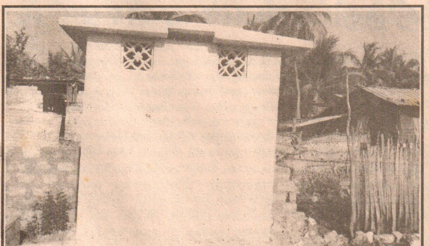
யாழ்ப்பாணம், பிரதேச செயலக சமுர்த்தி மாகாணக் கேள்/84 கிராமிய அபிவிருத்தி செயலகம் ஊடாக நாவந்துறை கலை வானி முன்பள்ளி மாணவர்களுக்காக 81,000 ரூபா செலவில் மலசல கூடம் ஒன்று புத்தாக அமைத்துக் கொடுக்கப்பட்டுள்ளதைக் காணலாம்.
