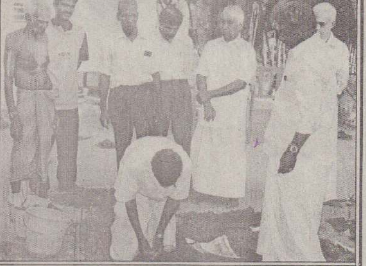
தாவடி கிந்து தமிழ்க்கலவன் பாடசாலைக்கு நீரித்தாங்கி அமைப்பதற்கான அடிக்கல் நடுநிகழ்வு அண்மையில் இடம்பெற்றது. எஸ்.ஆர். சரவணபவன் அடிக்கல் நடுவதையும் பாடசாலை அதிபர் செ.செல்வராஜா உட்பட ஏனையோர் அருகில் நிற்பதையும் படத்தில் காணலாம். (ஐ-10)
