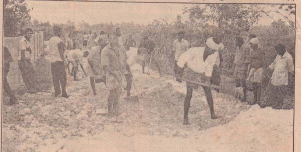
கைதடி மத்தியிலுள்ள முர்த்தியாவத்தை விவசாய வீதி, சமுர்த்தி அதிகாரசபையின் நிதியுதவியுடனும், அப்பகுதி மக்களின் பங்களிப்புகளும் அண்மையில் புனரமைக்கப்பட்டது. இந்த வீதியை சீர்தரமான முறையில் புனரமைக்கும் பணியில் கைதடி மத்தி வளர்மதி சனசபை முயற்சி செய்துள்ளது. (படம்: கைதடிச் செய்தியாளர்)
