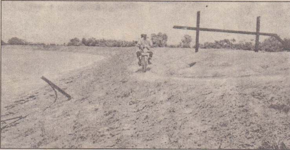
கிளிநொச்சி புதுமுறிப்புக் குளக்கட்டு மீது போக்குவரத்துச் செய்வது முற்றாகத் தடை செய்யப்பட்டிருந்தது. ஆனால், அதனையும் மீறி சைக்கிள்கள், மோட்டார் சைக்கிள்கள் இக்குளக்கட்டு வழியே பயணிக்கின்றன. இதனால், குளக்கட்டு இடிந்து மோசமான நிலைக்கு வந்திருக்கிறது. இதனைப் படத்தில் காணலாம். (படம்: ஜோ.யு.ஜேனியன், ஸ்கந்தபுரம் செய்தியாளர்)
