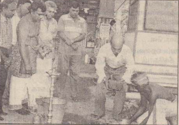
இலங்கைப் போக்குவரத்துச் சபையின் யாழ்.சாலையின் வளாகத்திலுள்ள ஞானவைரவர் ஆலயத்திற்கு மண்டபம் ஒன்று அமைக்கப்பட்டது. அதற்கான அடிக்கல் நாட்டு விழா கடந்த தைப் பூசுத்தினைத் தன்று நடைபெற்றது. விழாவில் யாழ்.சாலையின் பொது முகாமையாளர் க.கணேசபிள்ளை கட்டடத்திற்கான அடிக்கல்லை நட்டு வைப்பதையும் மற்றும் உத்தியோகத்தர்கள் அருகில் நிற்பதையும் படத்தில் காணலாம். (13)
