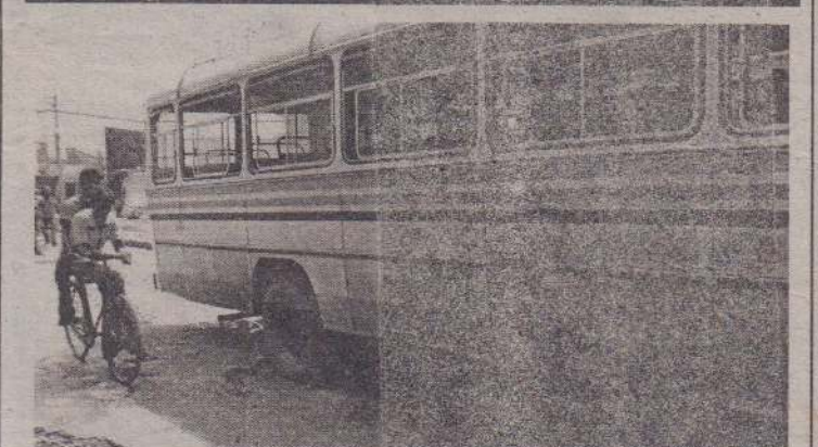
கவனிப்பார்களா? யாழ்.போதனா வைத்தியசாலைக்கு முன்பாக ஆஸ்பத்திரி வீதியில் உள்ள பெரும் குழிக்குள் நேற்று சனிக்கிழமை பயணித்துக் கொண்டிருந்த பஸ் ஒன்று புதைபுண்டுள்ளது. இதன் காரணமாக சில மணி நேரம் போக்குவரத்து நெரிசல் அந்த இடத்தில் ஏற்பட்டது. (7)
