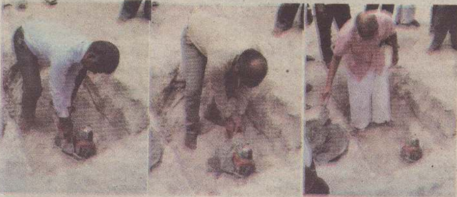
யாழ்.மாவட்ட நாடாளுமன்ற உறுப்பினர் எம்.ஏ.சுமந்திரனின் பன்முகப்படுத்தப்பட்ட வரவு - செலவுத்திட்ட நிதி ஒதுக்கீட்டின் மூலம், அமைக்கப்படவுள்ள வடமராட்சி கிழக்கு உடுத்துறை பாரதி சனசமூக நிலையத்துக்கான அடிக்கல் நடும் நிகழ்வு அண்மையில் நடைபெற்றது. நாடாளுமன்ற உறுப்பினர் எம்.ஏ.சுமந்திரன், வடமராட்சி கிழக்கு பிரதேச செயலர் கனகேஸ்வரன் மற்றும் பருத்தித்துறை பிரதேச சபை செயலாளர் ஸ்ரீபாஸ்கரன் ஆகியோர் கலந்து கொண்டு அடிக்கல்லை நட்பு வைத்தனர்.
