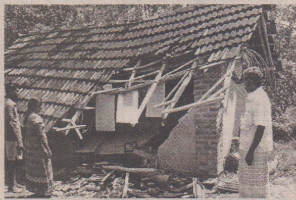
காட்டு யானைகளால் சேதப்படுத்தப்பட்ட வீடு.
