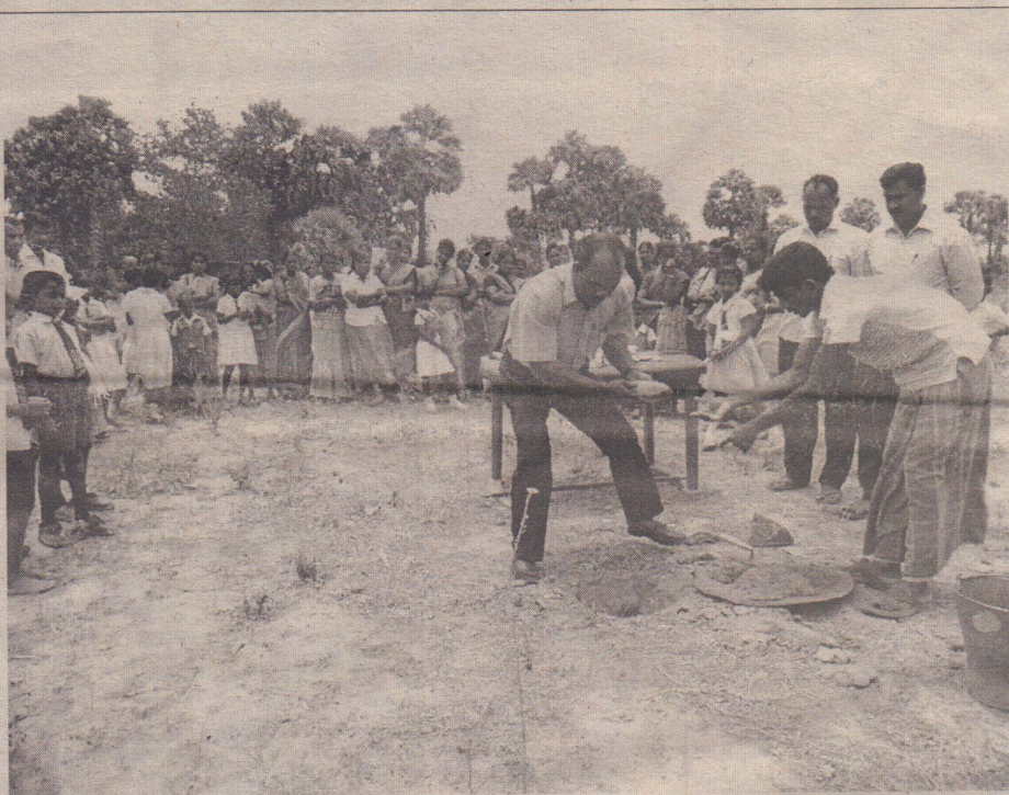
கிளிநொச்சி அக்கராயன் ஆரம்ப வித்தியாலயக் கட்டடங்கள் அமையவுள்ள காணிக்கான வேலி அமைக்கும் ஆரம்ப வேலைகளை ஆசிரிய ஆலோசகரான எஸ்.சகாயராசா அடிக்கல்லை நடந்து தொடக்கி வைக்கின்றார். (க-18)
