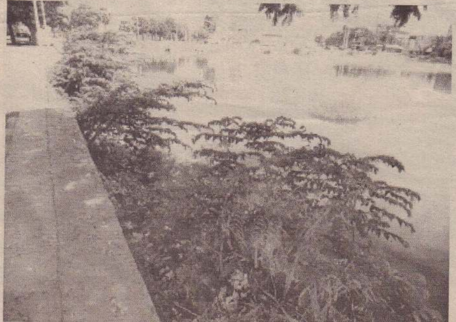
முற்றவெளியில் உள்ள புல்லுக்குளத்தின் பாதுகாப்பு அணைக்கட்டின் ஒரு பகுதி சேதப்படும் இதுவரைக்கும் அது சீர் செய்யப்படவில்லை. பாதுகாப்பு அணைக்கட்டு உடாக நடைபாதை செல்வதால் நடைபாதையால் பயணிக்கும் மக்கள் அச்சத்தின் மத்தியில் பயணிக்கின்றனர். (வ-17)
