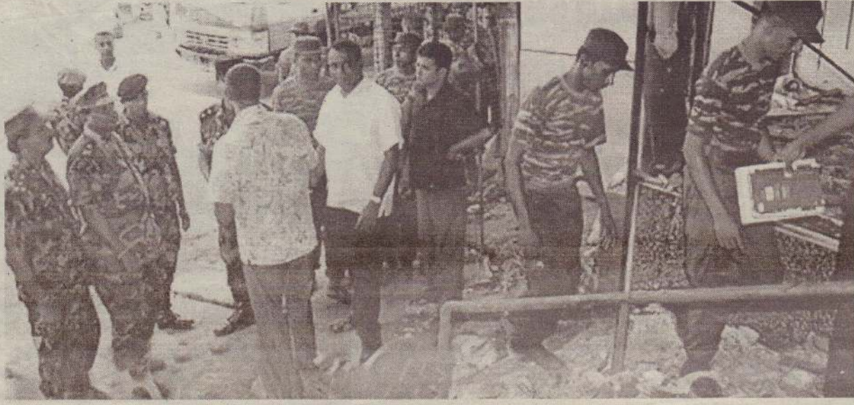
அளுத்தகம் தர்கா நகரில் அண்மையில் நடைபெற்ற வன்முறையின்போது தீக்கிரையாக்கப்பட்ட கட்டடங்களைச் சுத்திகரிக்கும் நடவடிக்கைகளில் இராணுவத்தினர் ஈடுபட்டிருப்பதைக் காணலாம். (ஓ)
