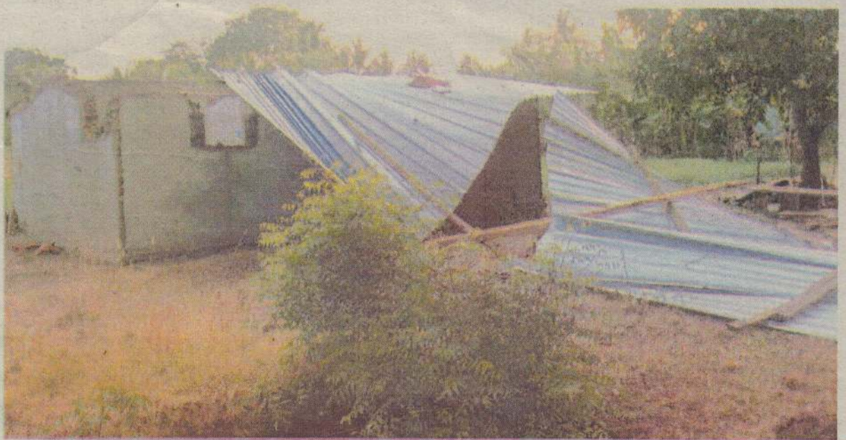
வவுனியாவில் கடந்த செவ்வாய்க்கிழமை சுழல்காற்று வீசியதில் கல்நாட்டியங்குளம் பகுதியில் உள்ள சுப்பிரமணியம் நாகரடணம் என்பவரின் வீட்டின் கூரைப் பகுதிகள் தூக்கி எறியப்பட்டு கட்டிடம் சேதமடைந்தது. (த-421)
