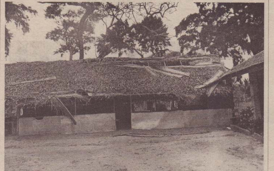
கிளிநொச்சி மாவட்டம் முக்கொம்பன் பாடசாலைக் கட்டடத்தின் மேற் கூரை காற்றினால் சேதமடைந்த நிலையில் காணப்படுகின்றது. (க-118)
