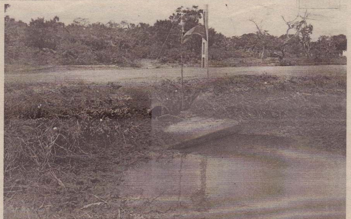
அக்கராயன் மருத்துவமனைக்கும், அம்பலப்பெருமாளுக்குள் சந்திக்கும் இடைப்பட்ட பகுதியில் அதிகாரிகளின் கண்களுக்கு இதுவரை தென்படாத நிலையில் உடைந்து சேதமடைந்து காணப்படும் மதகு. (க-18)
