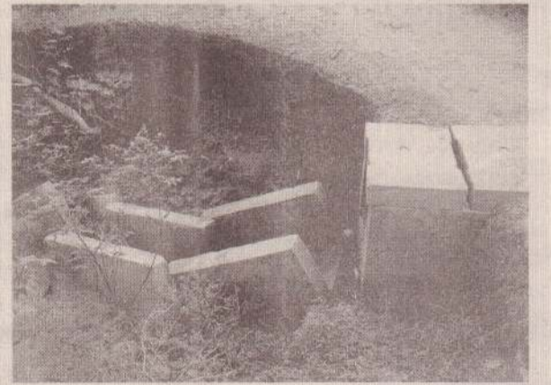
அண்மையில் பெய்த கனமழையால் ஏற்பட்ட வெள்ளம் காரணமாக ஒட்டுசுட்டான் கெருடமடுப் பகுதியில் வடிகான் உடைந்து சேதமாகியுள்ளது. அதனால் அந்த வீதியுடான போக்குவரத்து பாதிக்கப்பட்டுள்ளது. (ப-ரி1)
