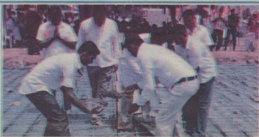
சாவகச்சேரியில் அமைக்கப்பட்டுள்ள விகாரைக்கு தாது கோபம் அமைப்பதற்கான அடிக்கல் நேற்று நடப்பட்டது. 523 ஆவது படைப் பிரிவின் தளபதி அடிக்கல்லை நடட்டார்.
