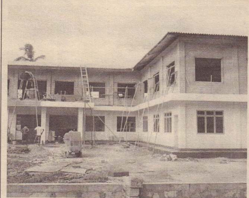
யாழ்ப்பாணம் பழைய பூங்கா வளாகத்தினுள் அமைக்கப்பட்டுவரும் வடமாகாண ஆளுநர் அலுவலக கட்டடப் பணிகள் துரிதமாக நடைபெற்று வருகின்றன. பழைய பூங்காவின் உள்ளே இருக்கும் நூற்றாண்டுகள் பழைமை வாய்ந்த மரங்கள் தறிக்கப்பட்டு மேலும் பல கட்டடத் தொகுதிகள் அமைக்கப்பட்டு வருகின்றமை குறிப்பிடத்தக்கது. (ம-135)
