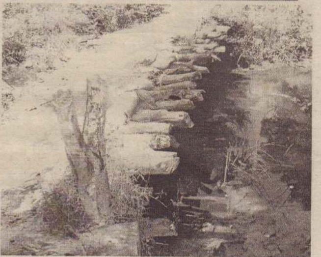
போக்குவரத்துச் சிரமங்களும் தோன்றியுள்ளன. எனவே உயிர்களைக் காவு கொள்ளும் வரை அதிகாரிகள் காத்திருக்காது இந்தப் பாலத்தை உடனடியாகப் புனரமைத்து வழங்குமாறு பிரதேச மக்கள் வேண்டுகோள் விடுத்துள்ளனர். (க-435)
