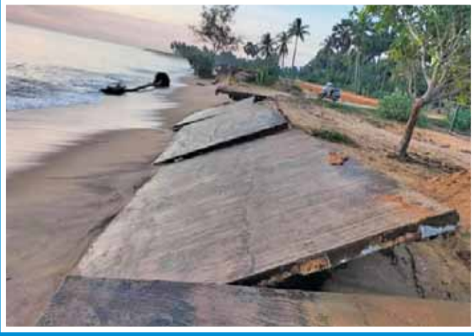
பாண்டிருப்பு கடற்கரையை அண்டிய பிரதேசம் கடலரிப்புக்கு உட்பட்டு வீதிகள் மற்றும் கட்டிடங்கள் அனைத்தும் சேதம் அடைந்துள்ளதை படத்தில் காணக்கூடியதாக உள்ளது. (சர்ஜன் லாபர்)
