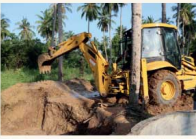
கிடைக்கவில்லை தண்ணீர் நிரம்பிக் காணப்படுவதால், தண்ணீரை இழக்கும் நடவடிக்கை முன்னெடுக்கப்பட்டு, தொடர்ந்து கரைகு இயந்திரம் கொண்டு, சுமார் பத்து அடி ஆழம் வரையில் தோண்டப்பட்டுள்ளது.
