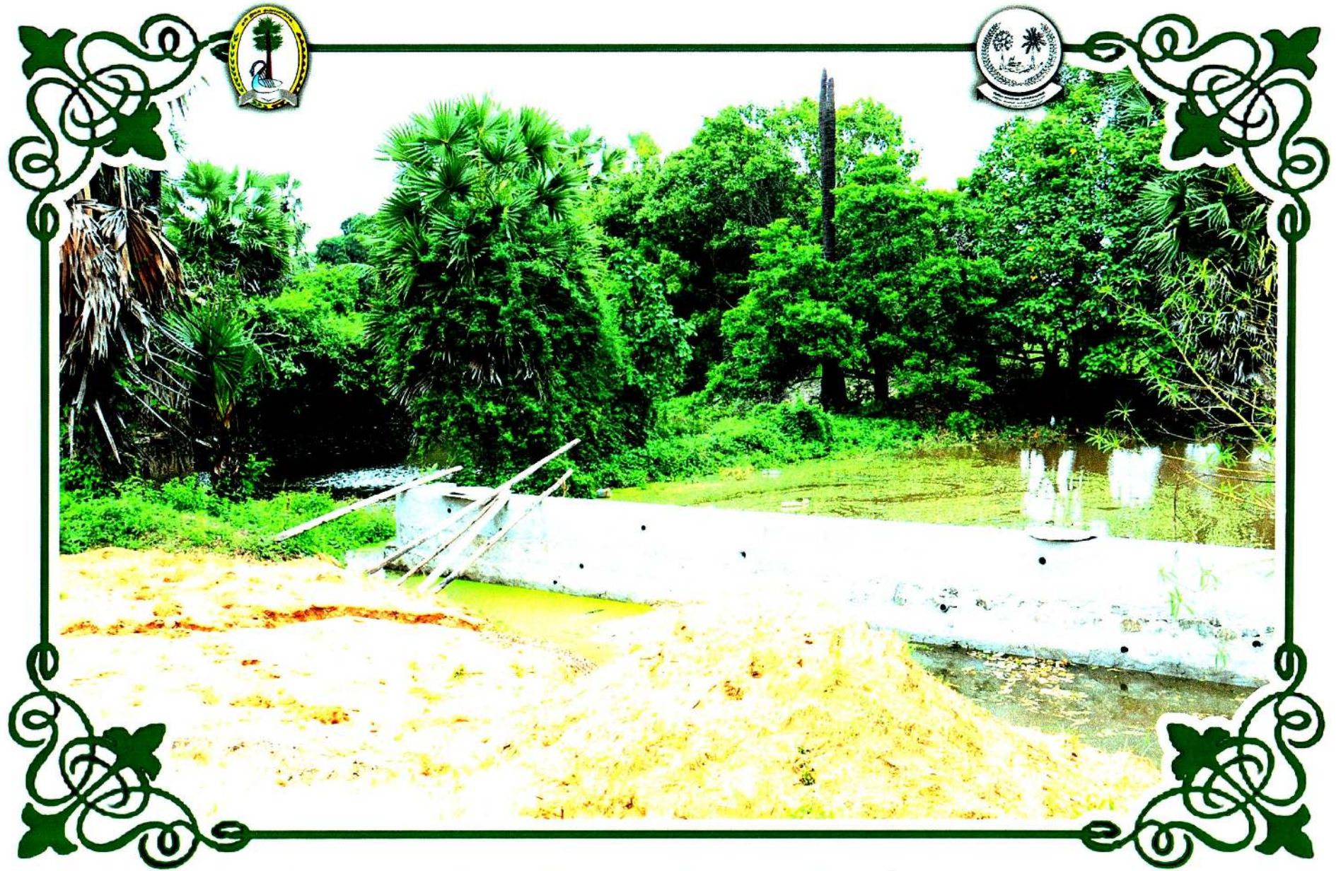
அழிவடைந்த நிலையிலுள்ள இரட்டைக்கேணி - பளை Damaged Condition of Eradaikerni - pallai හානි වී ඇති ඉරට්ටේකේනි - පලයි
